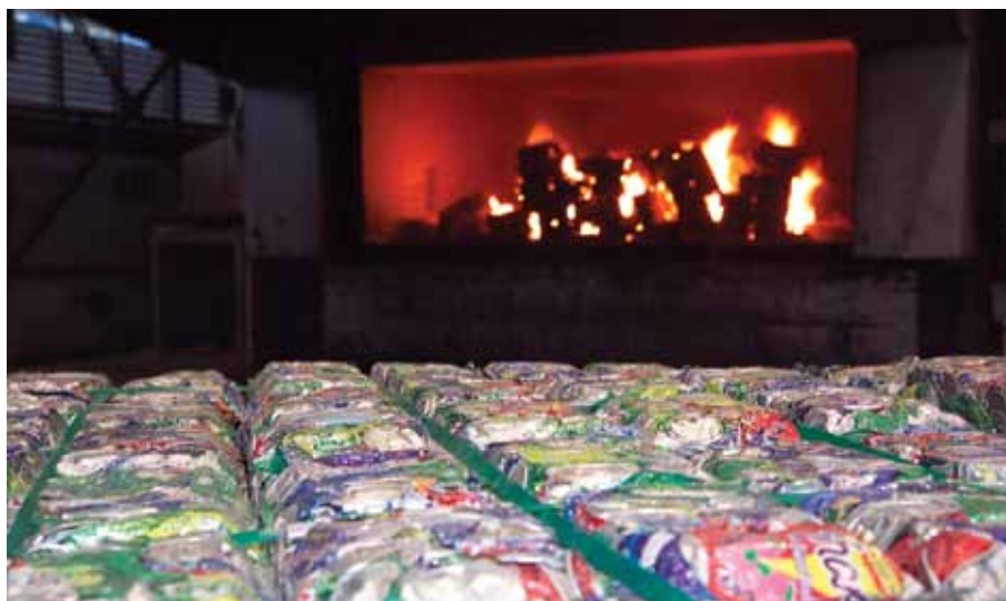
Βιομηχανία ΕΛΒΑΛ - Φούρνος αποπλάκωσης
